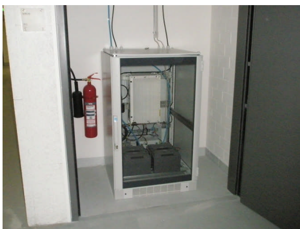
Remote Unit (TMO Repeater) und unabhängige Stromversorgung.
