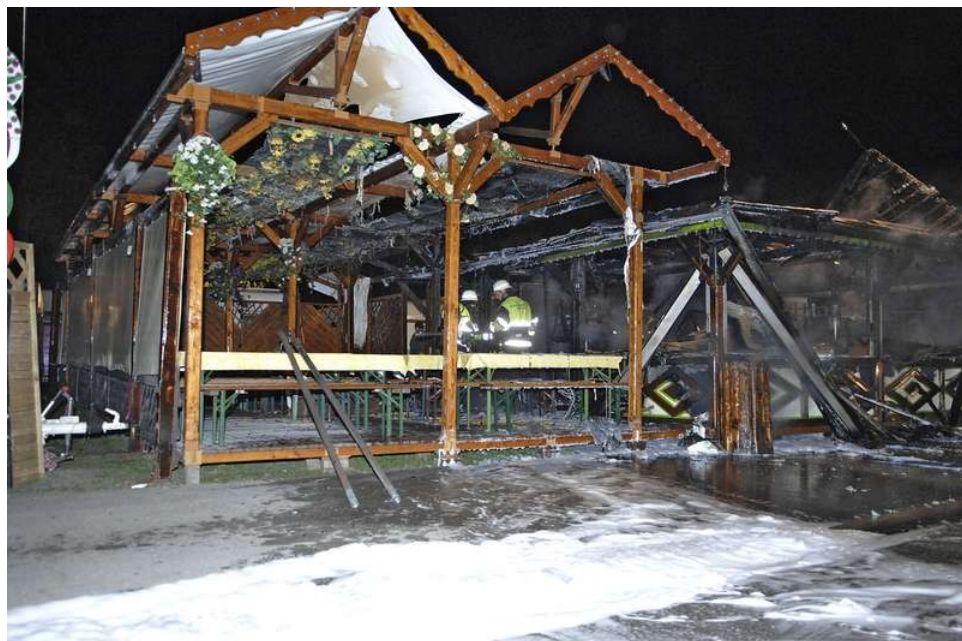
Abbildung 4 - Durch Brand zerstörter Gastronomiestand
